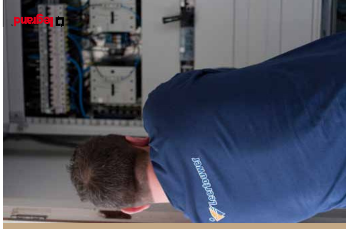
▲ Een technicus van Leertouwer monteert één van de verdelers
